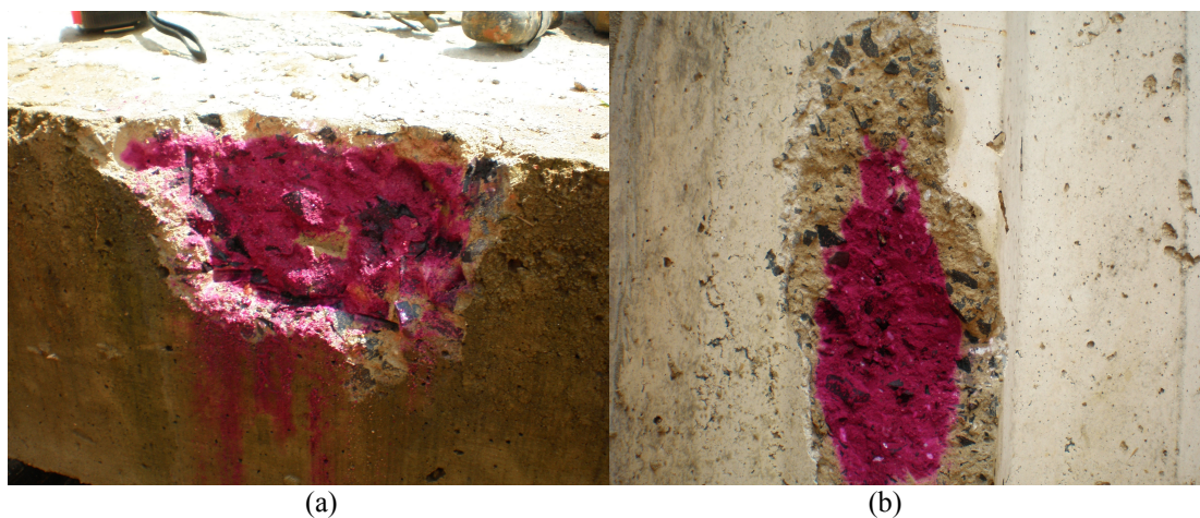
Figura 7 (a e b) avaliação de carbonatação numa cinta inferior externa e um pilar externo.
