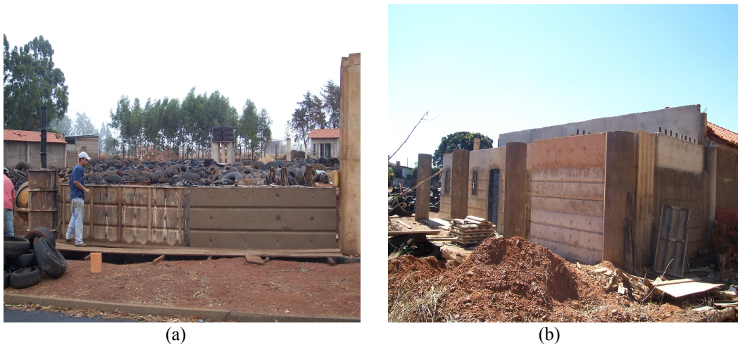
Figura 10 (a e b) – Execução dos painéis de paredes em concreto com entulho de demolição, fragmentos de borracha de pneus, garrafa PET e vidros.
