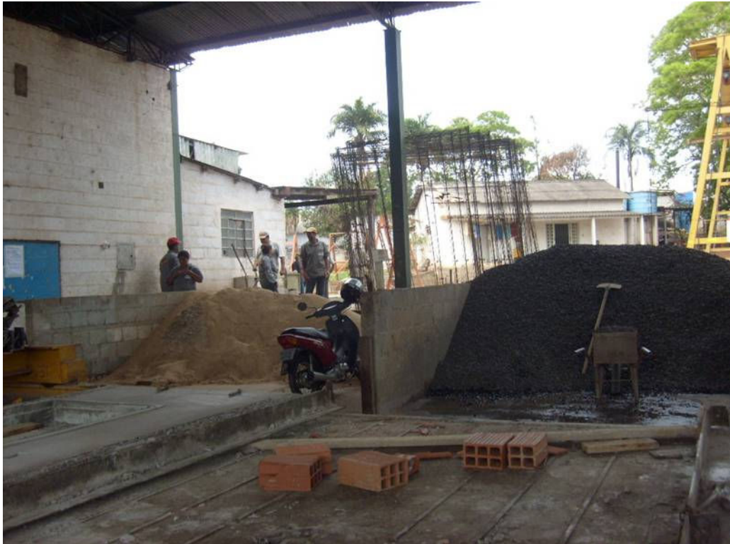
Figura 4: Baías de armazenagem de areia e brita, com identificação.
