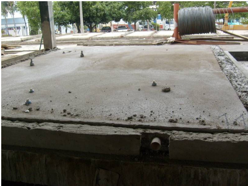
Figura 19: Painel parede já revestido em uma das faces mostrando a saída de hidráulica.
