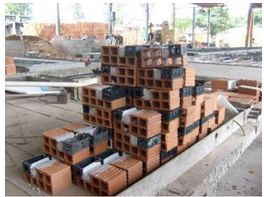
Figura 18: Caixas elétricas chumbadas.
